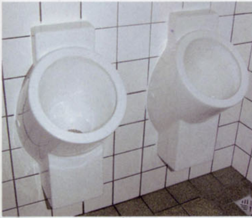
Die Herrentoiletten wurden mit je zwei wasserlosen Centaurus-Urinalen von Keramag ausgestattet.
