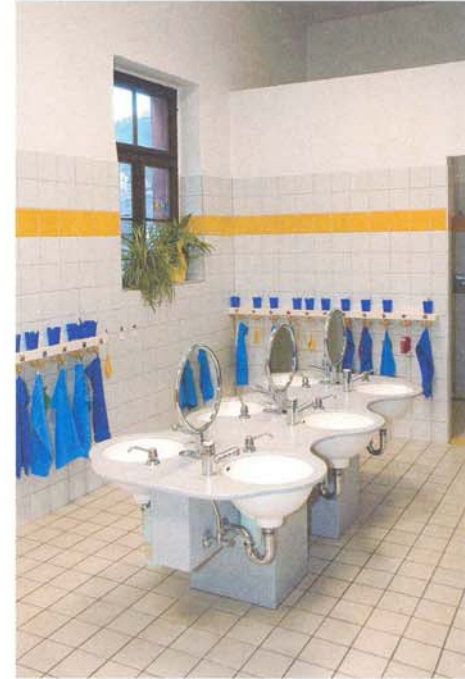
Bild 3 • Säulenverkleidung, Waschtischplatte und Waschbecken bestehen bei dieser Waschtischlösung aus dem Mineralwerkstoff „Varicor“. Da er kratz-, schlag- und stoßfest ist, gehören Beschädigungen, die selbst im normalen Kindergartenbetrieb entstehen können, der Vergangenheit an.
