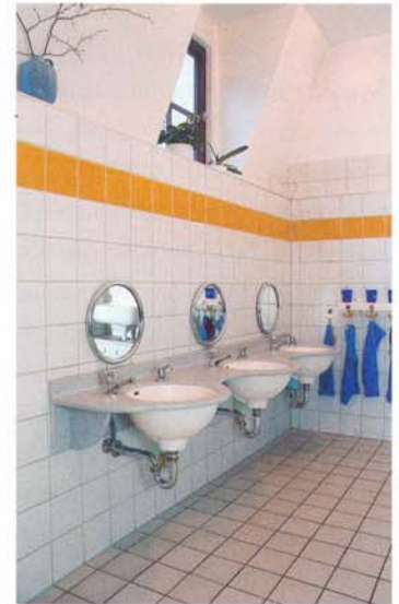
Bild 6 • Die extra tiefen Becken dieser Waschtischanlage sind, ebenso wie die Grundplatte, aus „Varicor“ gefertigt. So können die Kinder nach Herzenslust darin planschen, ohne dass gleich die Gefahr einer Überschwemmung besteht.
