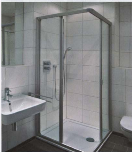
Bild 2 • Das Relaxen nach schweißtreibendem Training beginnt jetzt schon unter der Dusche: Die Marken-Eckduschabtrennung SupraTop auf Duschwanne Terra sorgt mit transparenter Leichtigkeit nicht nur für eine freundliche Atmosphäre im Spielerbad, sondern auch für ein wohlige Dushvergnügen ohne Spritzwasser im Raum.
