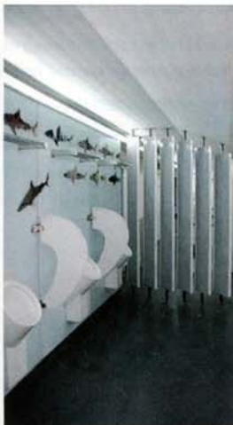
Bild 10 • Sichtschutz trotz optischer Leichtigkeit: Die eleganten Urinal-Trennwände Separo sind aus dem hygienischen Mineralwerkstoff Varicor gefertigt und lassen sich durch ihre geringen Wandkontaktflächen ausgesprochen einfach und schnell reinigen.
