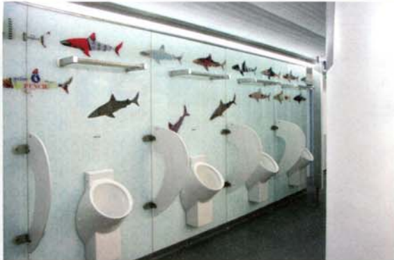
Bild 5 • Hochwertige Optik: Für die Gestaltung der Sanitäranlage kam ein Materialmix aus Glas, Keramik, Edelstahl und Mineralwerkstoffen zum Einsatz.
