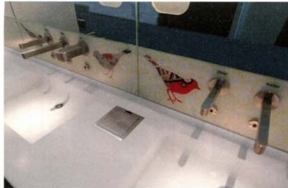
Bild 11 • Berührungslos: Die Waschtische aus gegossenem Mineralwerkstoff sind mit wandinstallierten sensorgesteuerten Armaturen ausgestattet.
