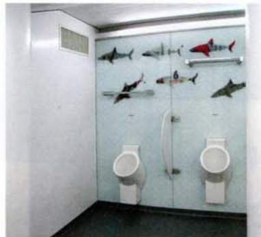
Bilder 12 + 13 • Aufwändige Technik: Aufgrund der niedrigen Decken musste u. a. die Belüftung und Beleuchtung im oberen bzw. mittleren Wandbereich untergebracht werden.
